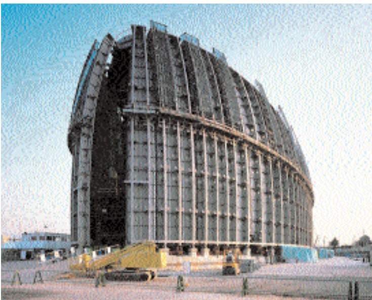
2 | In zes dagen tijd zijn de 120 scharnierende gevelementen 'uitgevouwen' met behulp van 32 hefinstallaties (twee hydraulische vijzels per stuk) en tijdelijke ondersteuning
